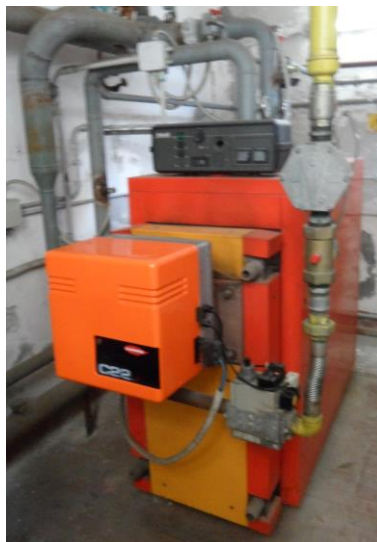
Figura 4.14 – Particolare del generatore di calore a basamento
