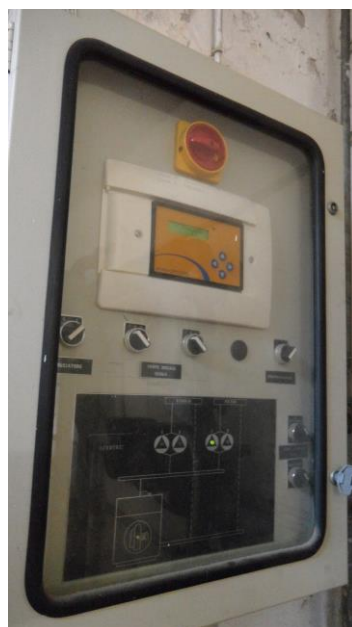
Figura 4.11 – Particolare centrale termica – Cronotermostato
